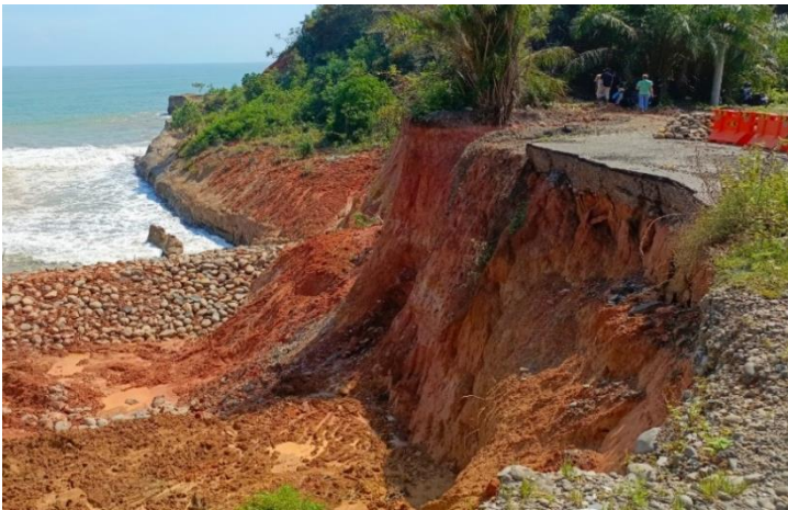
Gambar 4 Kondisi abrasi di pesisir Kecamatan Ketahun (3°26'32.77"S, 101°54'46.86"E), Bengkulu Utara (Sumber : Dokumentasi Pribadi)
